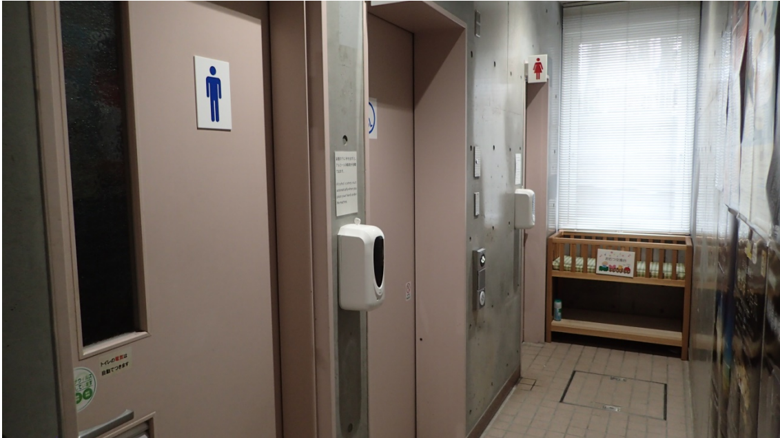
男子トイレ（多目的トイレ）、女子トイレ前に個別に手指消毒剤ディスペンサーを設置
