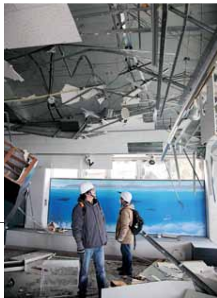
落下した2階展示室の天井
