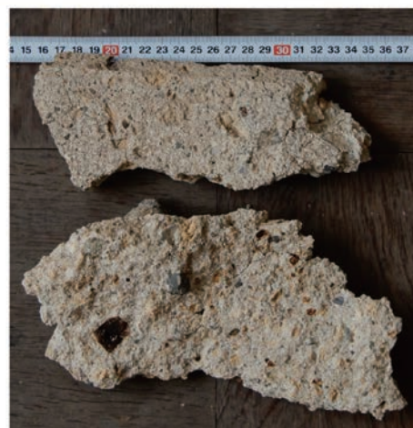
図2 馬事博物館の腰部石材の劣化状況 (図版提供: 竹駒神社) (上) 基壇の亀裂の状況 (南側) (下) 基壇崩落石 (採取試料)
