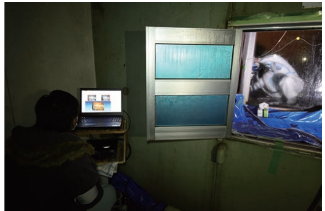
計測機からのケーブルはビニールを巻いて養生し前室に設置した PC に接続
